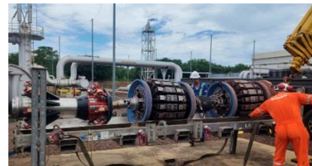
Figura 15 – Inspeção por PIG instrumentado
