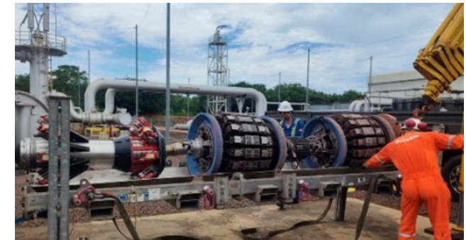
Figura 15 – Inspeção por PIG instrumentado
