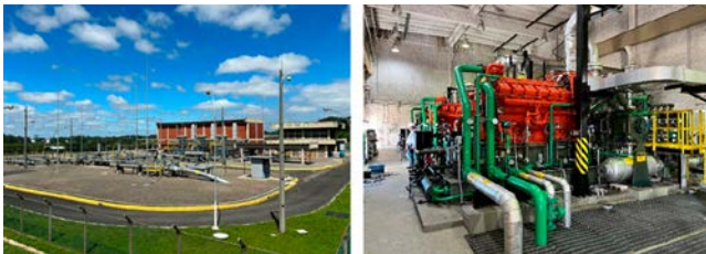
Figura 17 – Vista geral da Estação de Compressão de Araucária/PR
