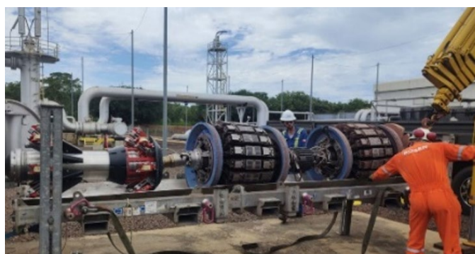
Figura 19 – Inspeção por PIG instrumentado
