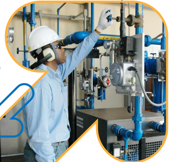
↑ Técnico na Estação de Compressão de Mirandópolis
