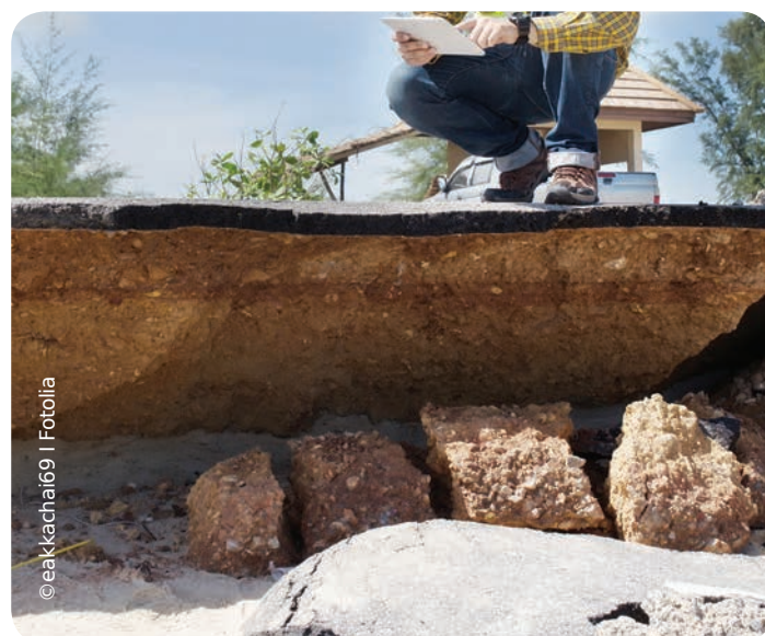
Exemplo dos danos da erosão no solo
