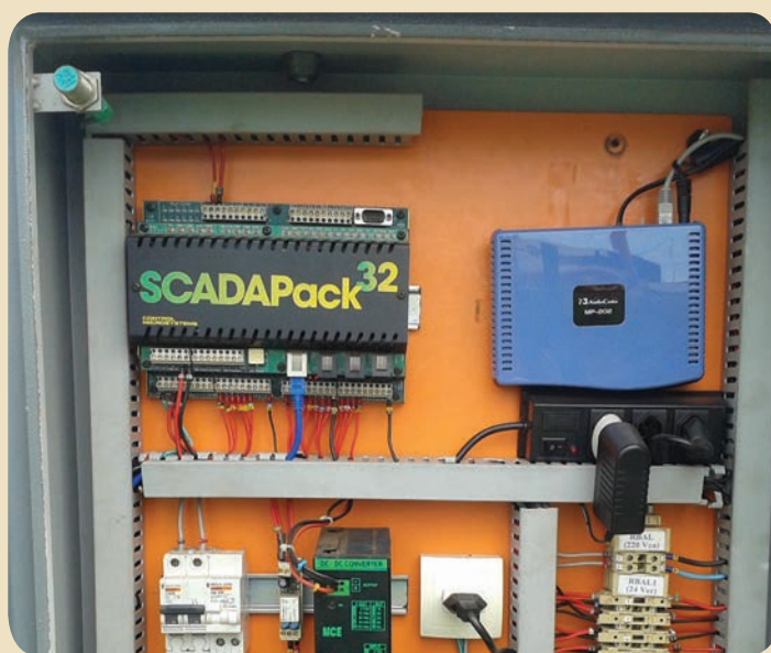
Detalhe do painel de monitoramento remoto
