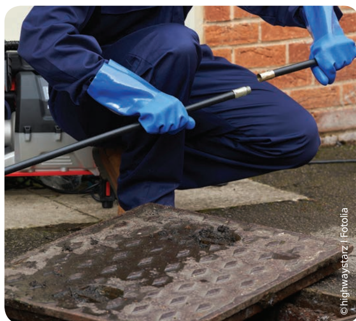
Bueiros limpos facilitam o escoamento da água
